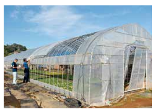
風により入口ドアは破損し天井部分はめくれパイプも大きく曲がった
